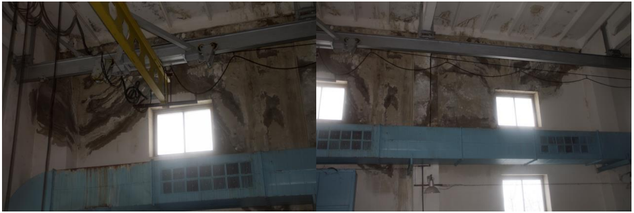
Рисунок 26 – Визуальный осмотр трещин стен и дефектов кровли здания 23 (II подъём)
