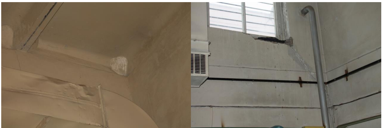
Рисунок 18 – Визуальный осмотр трещин стен здания 25 (хлораторная)
