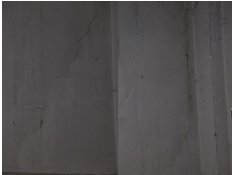
Рисунок 11 – Визуальный осмотр трещин здания компрессорной
