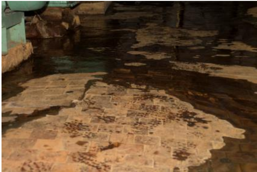
Рисунок 14 – Визуальный осмотр трещин пола компрессорной
