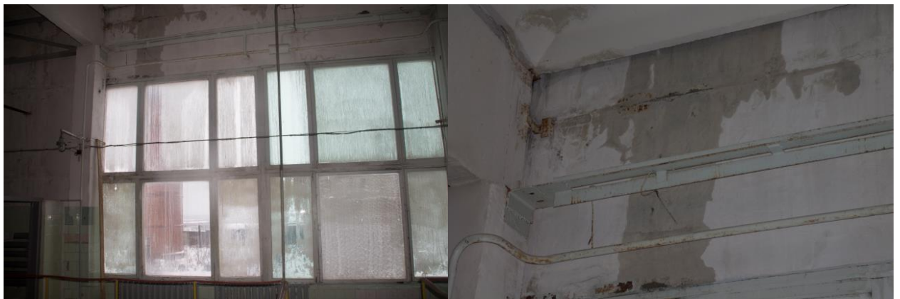
Рисунок 22 – Визуальный осмотр трещин стен и дефектов кровли здания 22
