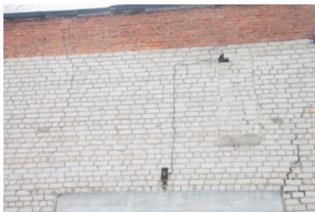
Рисунок 9 – Визуальный осмотр трещин здания компрессорной
