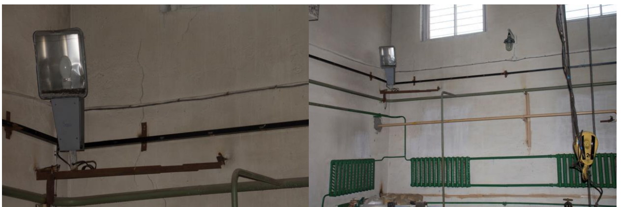
Рисунок 19 – Визуальный осмотр трещин стен здания 25 (хлораторная)
