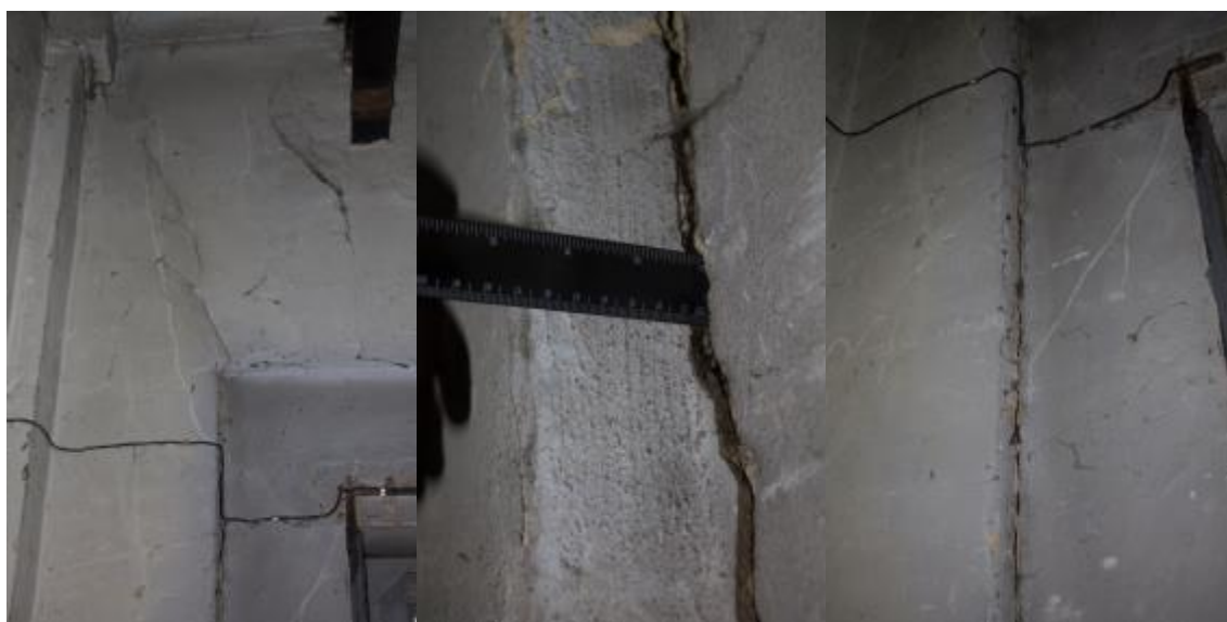
Рисунок 10 – Визуальный осмотр трещин здания компрессорной
