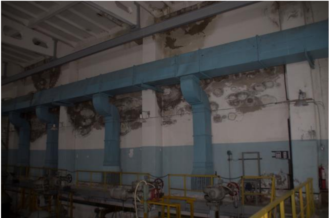
Рисунок 27 – Визуальный осмотр трещин стен и дефектов кровли здания 23 (II подъём)
