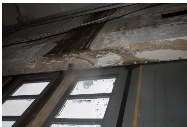
Рисунок 25 – Визуальный осмотр трещин стен и дефектов кровли здания 22
