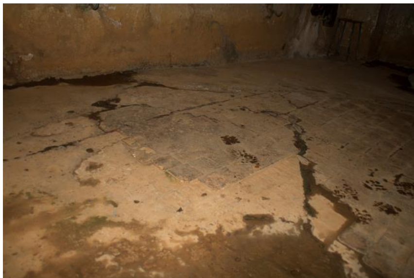
Рисунок 12 – Визуальный осмотр трещин пола компрессорной
