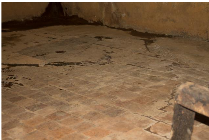
Рисунок 13 – Визуальный осмотр трещин пола компрессорной
