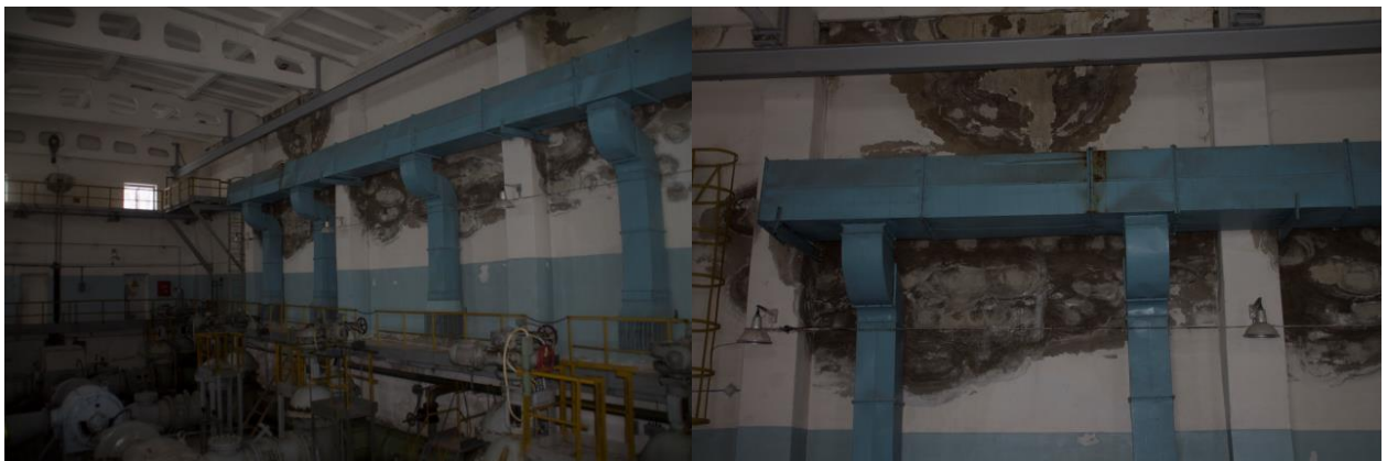
Рисунок 28 – Визуальный осмотр трещин стен и дефектов кровли здания 23 (II подъём)
