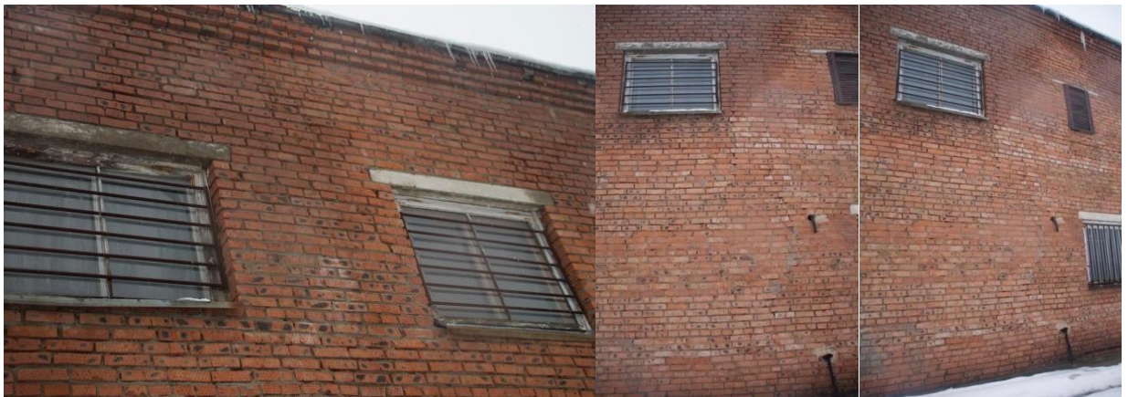
Рисунок 21 – Визуальный осмотр трещин стен здания 25 (хлораторная)
