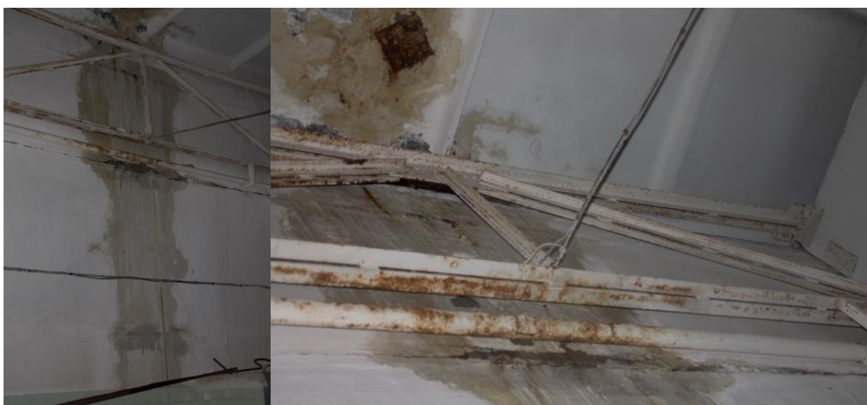
Рисунок 24 – Визуальный осмотр трещин стен и дефектов кровли здания 22
