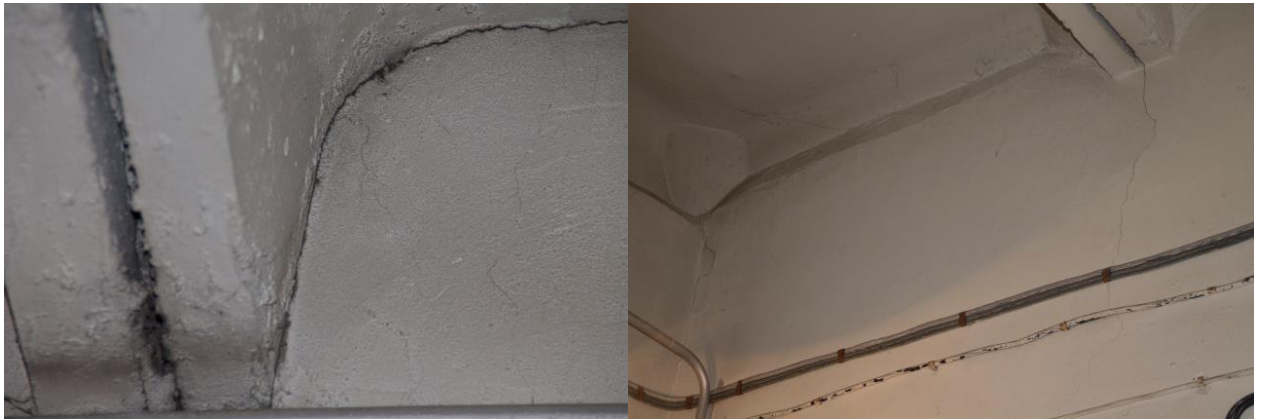
Рисунок 17 – Визуальный осмотр трещин стен здания 25 (хлораторная)
