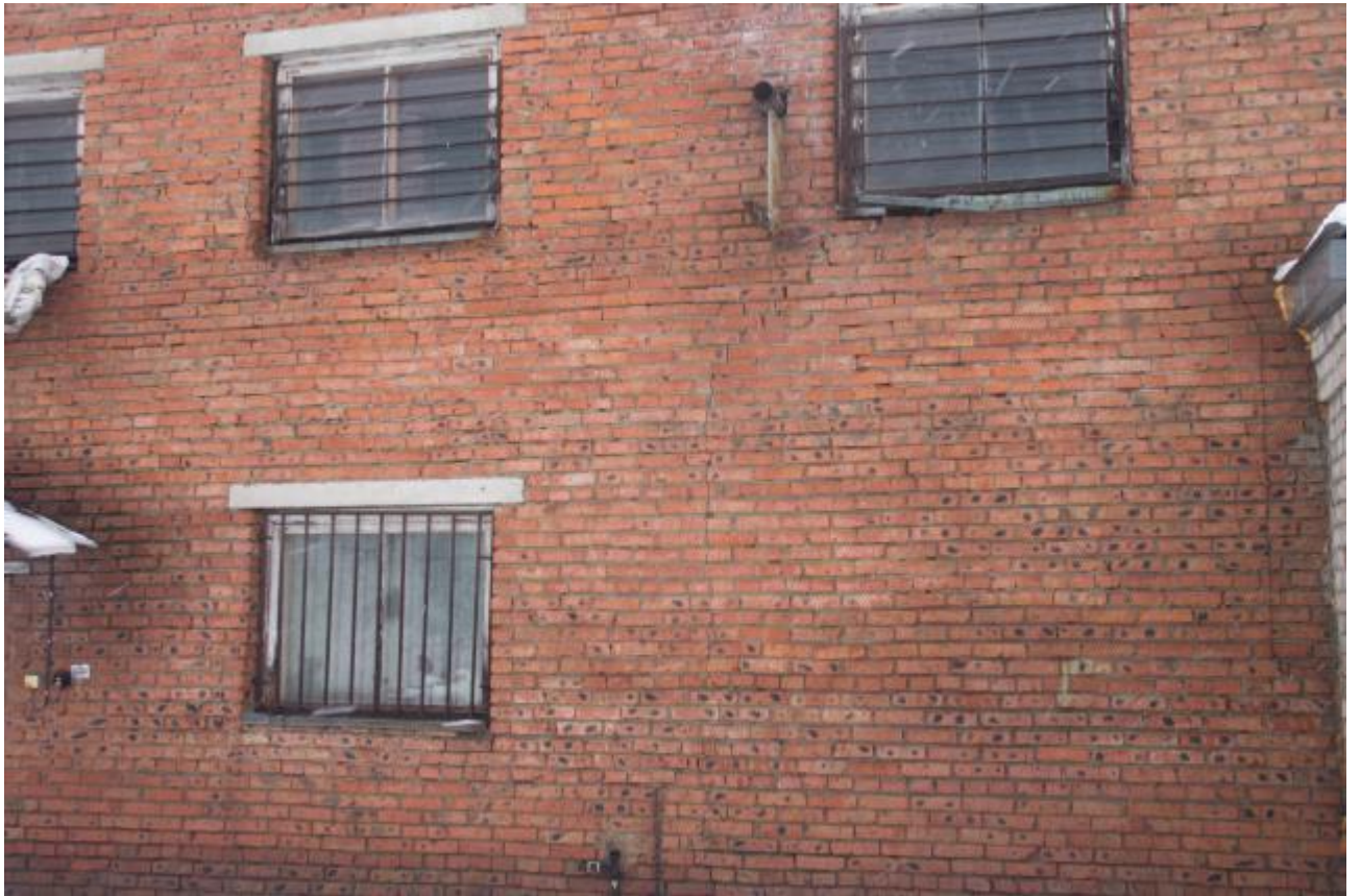
Рисунок 20 – Визуальный осмотр трещин стен здания 25 (хлораторная)
