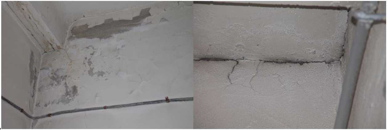
Рисунок 16 – Визуальный осмотр трещин стен здания 25 (хлораторная)
