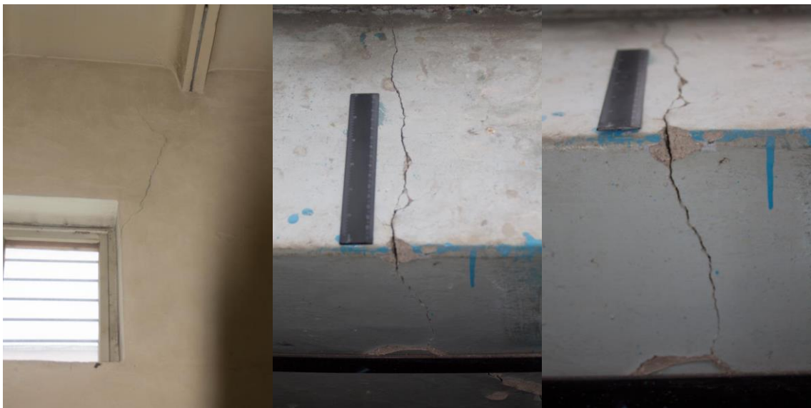
Рисунок 15 – Визуальный осмотр трещин стен здания 25 (хлораторная)
