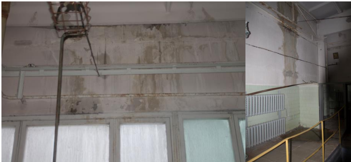
Рисунок 23 – Визуальный осмотр трещин стен и дефектов кровли здания 22
